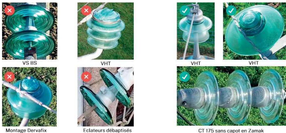
Figure 4 : L'IA pour le diagnostic des ouvrages (détection d'une anomalie sur un support de ligne HTA par traitement d'image) (Source : Enedis).
