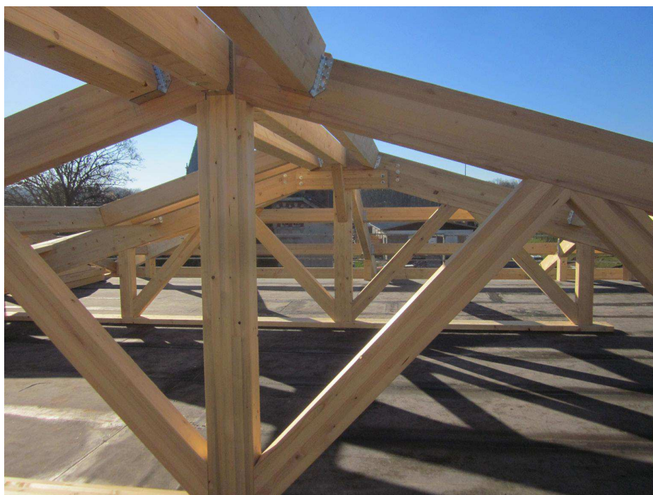
Figure 7 : Bâtiment ONF - Chambre d'Agriculture d'Épinal. Charpente constituée de sapin sain (lamellé collé) et d'épicéa scolyté (poutres) sans altération mécanique du bois (crédit photo : Denis Dagneaux, ONF Grand Est).
