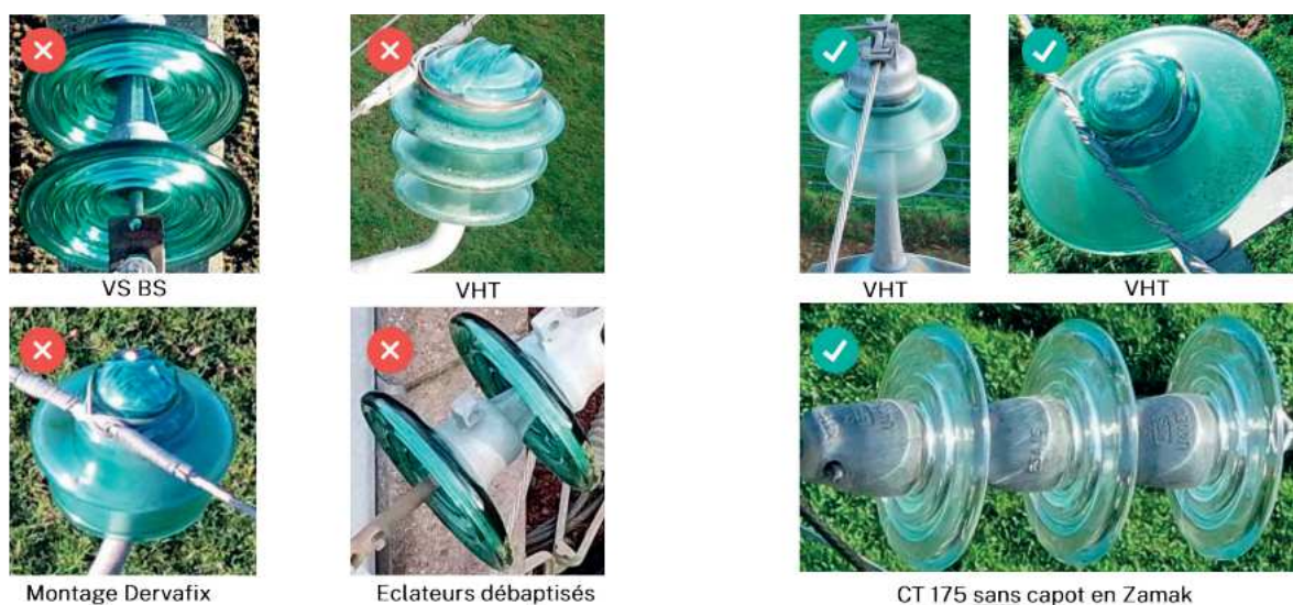
Figure 4 : L'IA pour le diagnostic des ouvrages (détection d'une anomalie sur un support de ligne HTA par traitement d'image) (Source : Enedis).
