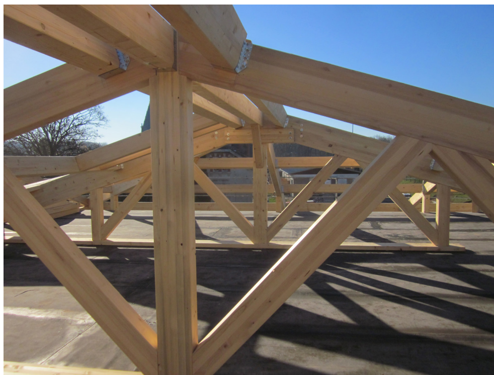
Figure 7 : Bâtiment ONF - Chambre d'Agriculture d'Épinal. Charpente constituée de sapin sain (lamellé collé) et d'épicéa scolyté (poutres) sans altération mécanique du bois (crédit photo : Denis Dagneaux, ONF Grand Est).
